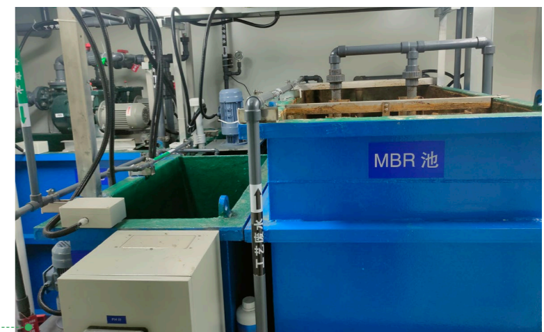
百洋生物诊断引进全新废水处理系统
